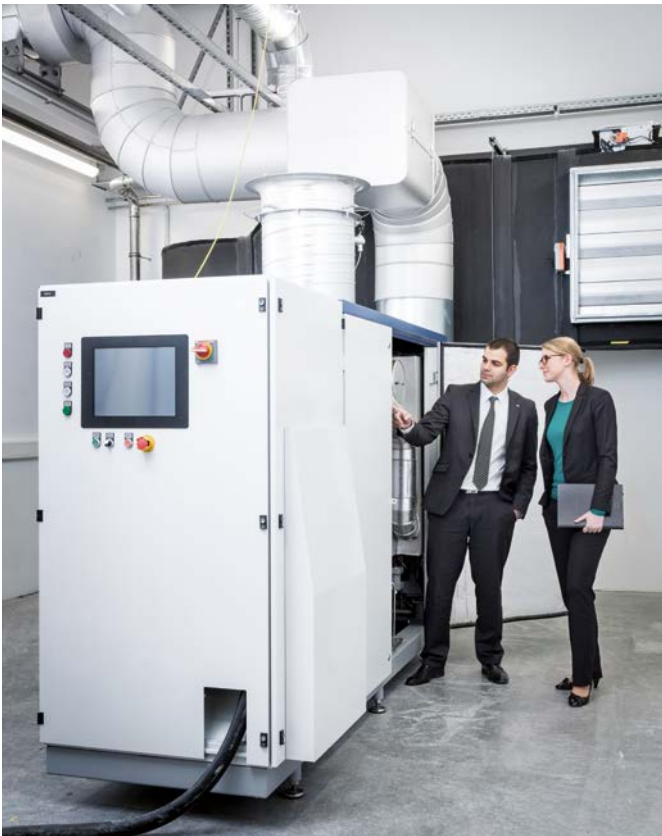
Das Compact Power System (CPS) von Dürr erzeugt mit einer Mikrogasturbine Wärme und Strom. Daneben Corinna Wehle mit Vertriebsingenieur Daniel Barunovic
